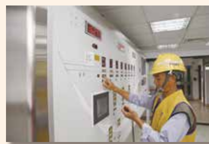
控制室值班人員遠端操控閘門
