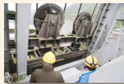
汛期前沖刷道擋水閘門試操作
